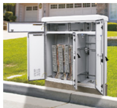
ARMÁRIO ATIVO FINALIZADO
