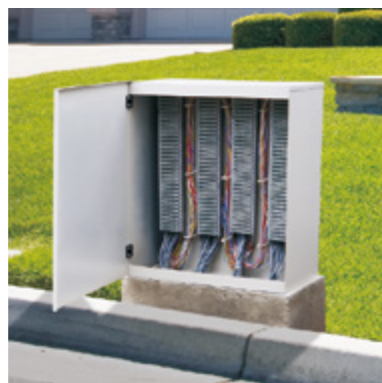
ARMÁRIO PASSIVO - ABERTO
